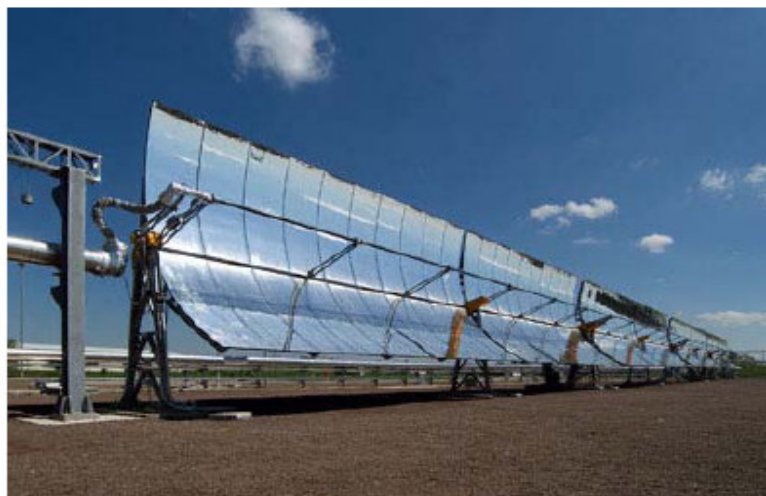
Figura 16 – Tecnologia ENEA in prova presso il centro della Casaccia
